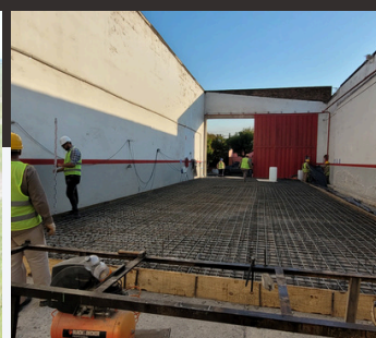
Obra Civil y Sistema PAT - Sistema Contra Incendios
