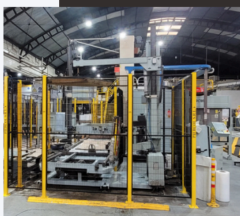
Sistema de Protección de líneas de producción
